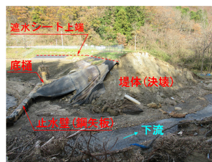
(a) 破堤の状況
